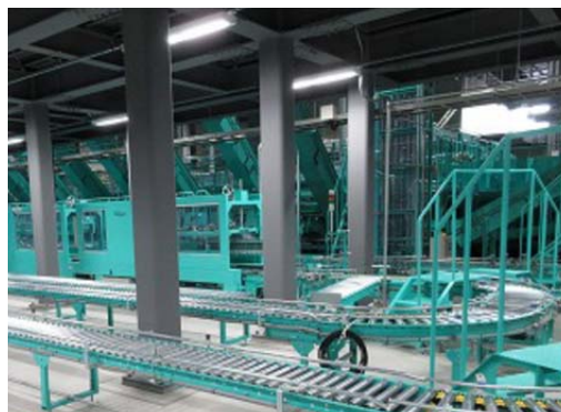
箱詰製品搬送設備
