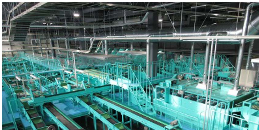
前処理・選別設備 全景
