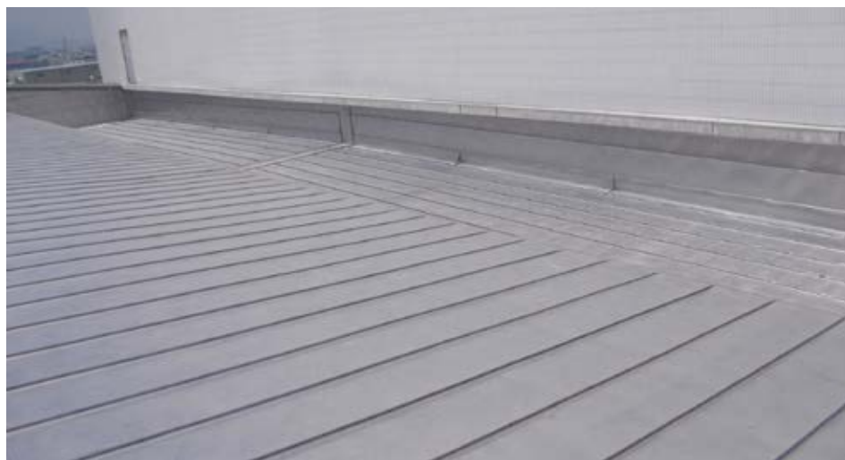
屋根側から樋部分を眺める。樋の向こうには舞台部分の高い壁面が立ち上がっている
