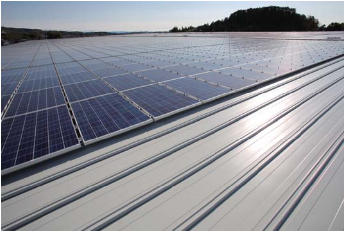
(仮称) 濃飛西濃運輸富加物流センター太陽光発電工事 (岐阜県加茂郡) ●屋根仕様/瓦棒F-40-K (ハイタフの上カバー改修) フッ素樹脂ガルバリウム鋼板 t=0.4mm 17,960㎡ ソーラーシステムSフィット (kW) ●設計・施工/㈱ミライト
