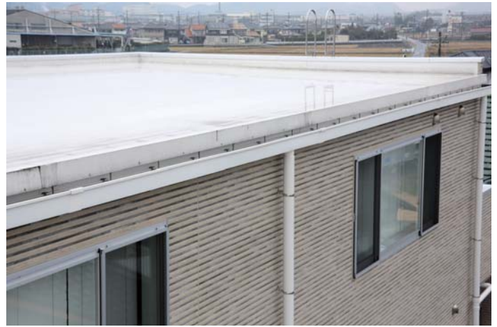
平手みよ子様事務所 (愛知県犬山市) ●屋根仕様/ハイタフルーフィングシステム EP t=1.14mm 205㎡ ●設計/㈱ヒラテ技研 ●施工/名稲建設(株)
