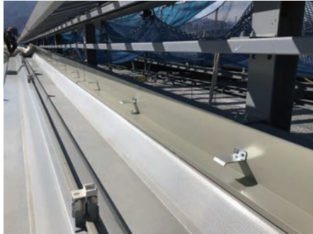
大屋根(吸音ダブルバック丸馳折版Ⅱ型) ハイサイドライト取合 特注の下地金具を使用し、 役物が小さく、シャープに納まっている
