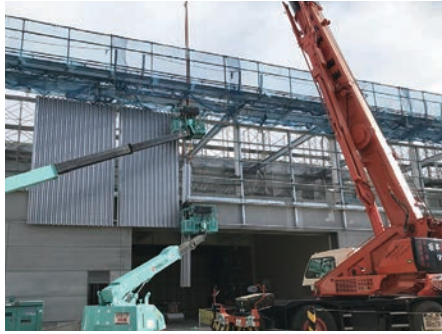
外壁特寸折版貼施工時 無足場工法での施工のため、高所作業車を使用し、 レッカーの合番作業にて施工
