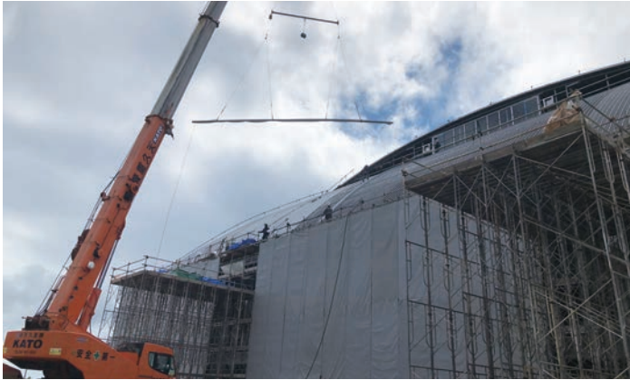
屋根材の荷揚げ。いったん屋根材を水平に吊り上げてウインチで勾配を付けながら下げて設置
