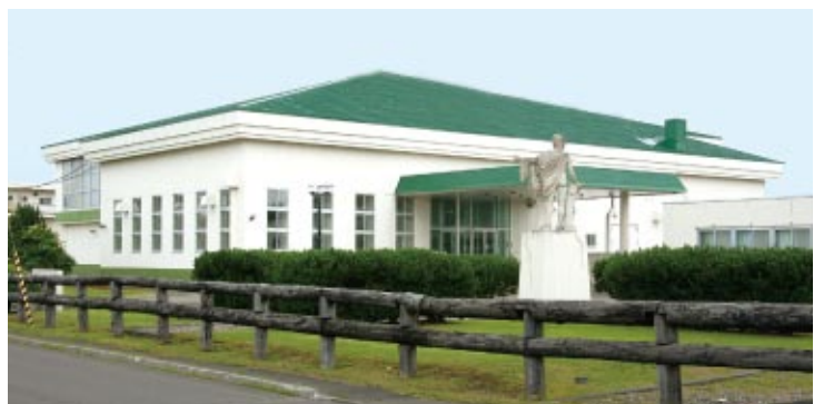
㈱大塚製薬工場 釧路工場体育館屋根改修工事（北海道釧路市）
